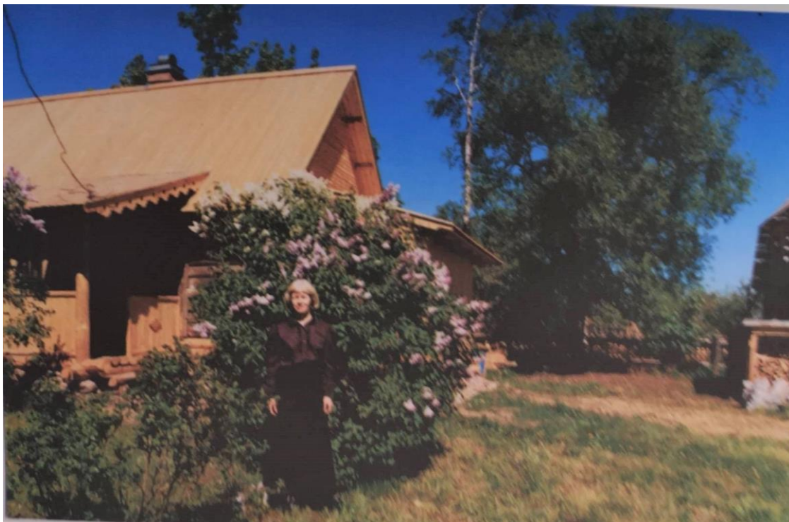
Илл. 38. Деревня Кобрينو, дом 27. ОКН «Дом, где бывала няня А.С. Пушкина - Арина Родионовна». Фото 2002 г.// Фотофиксация в процессе авторского надзора. ГП СПбНИИНИ "СПР". 2002 г. (Проект ремонта и консервации дома НИИ СПР. 1999 г.). Архив комитета по сохранению культурного наследия Ленинградской области. №п/п 8165. № дела 461-13.
