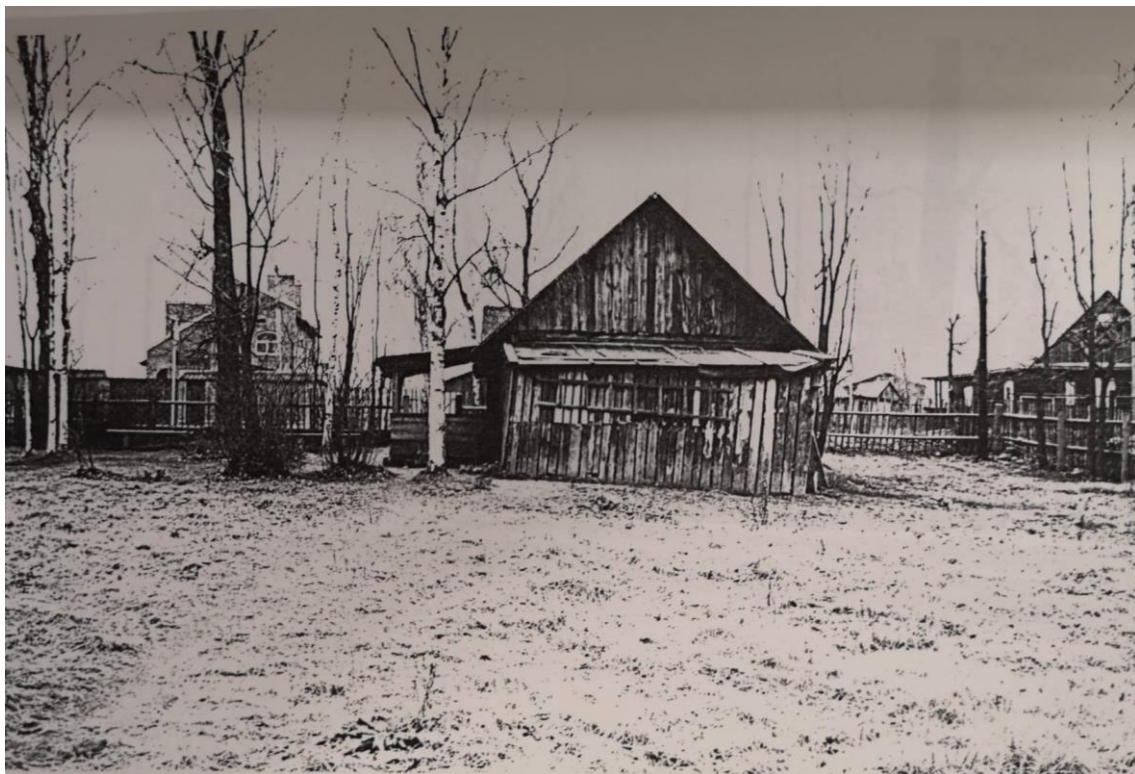
Илл. 34. Деревня Кобрино, дом 27. ОКН «Дом, где бывала няня А.С. Пушкина - Арина Родионовна». Фото 1999 г. // Проект ремонта и консервации дома НИИ СПР. 1999 г. Архив комитета по сохранению культурного наследия Ленинградской области. №п/п 7417. № дела 461-12.
